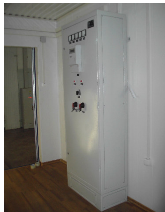
Рисунок 2.2. Щит собственных нужд столовой 11 блок-боксов.
