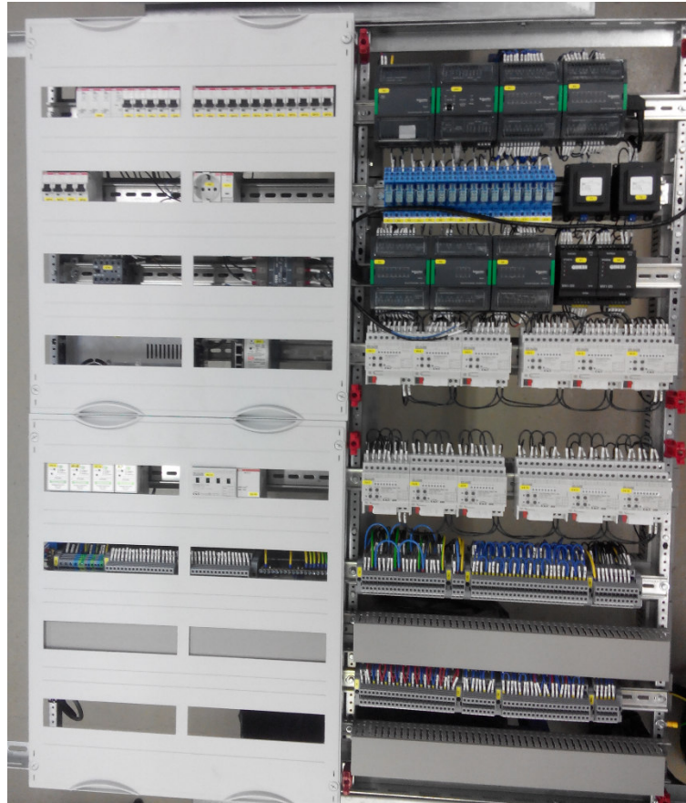
Рисунок 1.14. Шкаф автоматизации инженерных систем на контроллере Schneider Electric. Процесс сборки.
