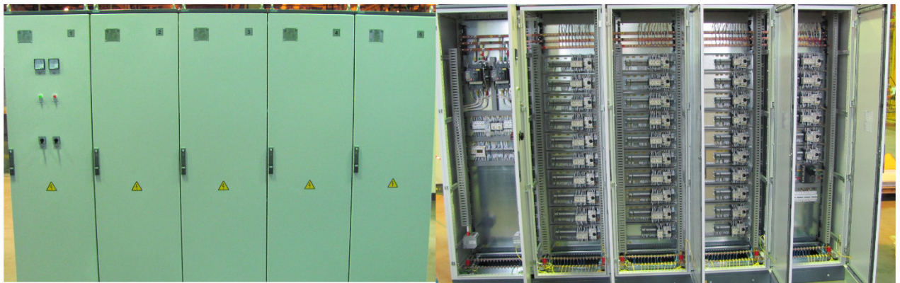
Рисунок 2.16. Щит станции управления ЩСУ-0,4кВ.
